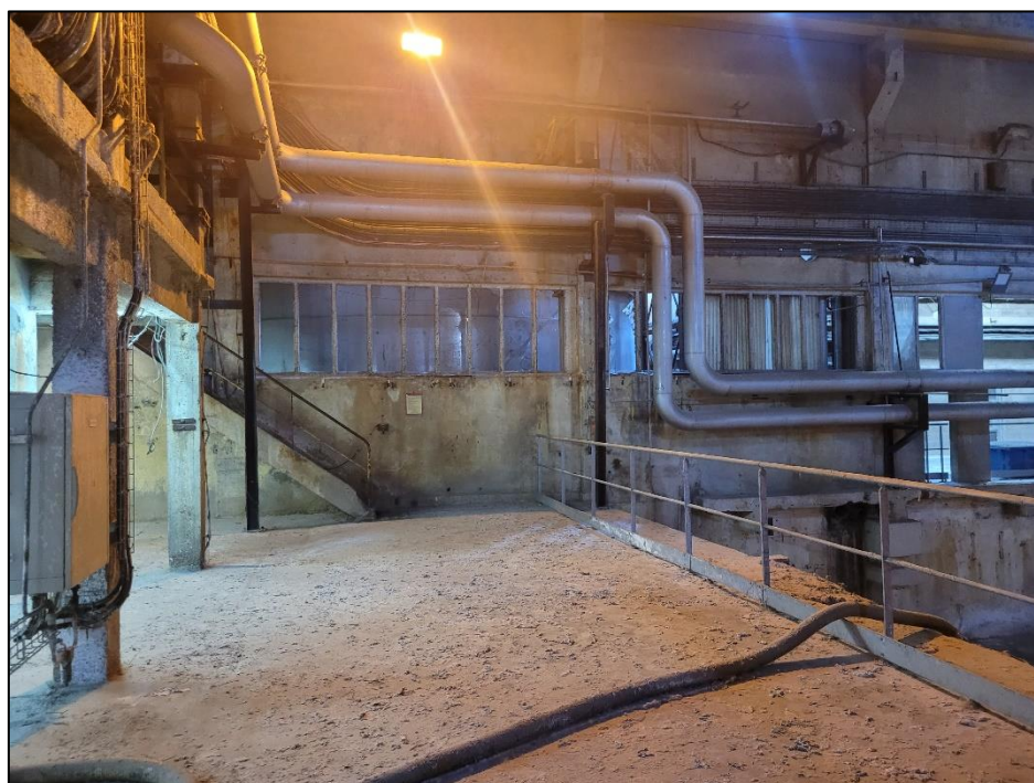
Figure 20. Zone de stockage des produits chimiques
